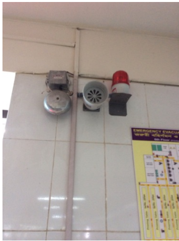
Exemplar fire alarm
