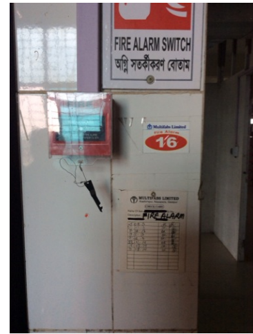
Exemplar fire alarm switch
