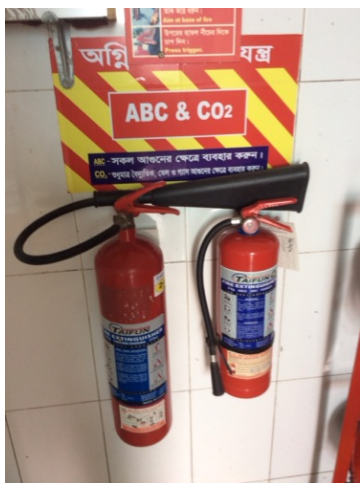
Exemplar fire extinguisher
