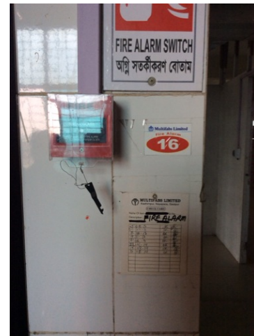
Exemplar fire alarm switch
