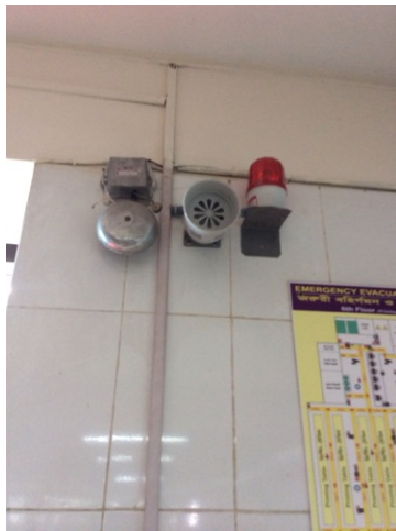
Exemplar fire alarm
