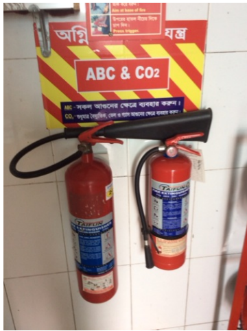
Exemplar fire extinguisher
